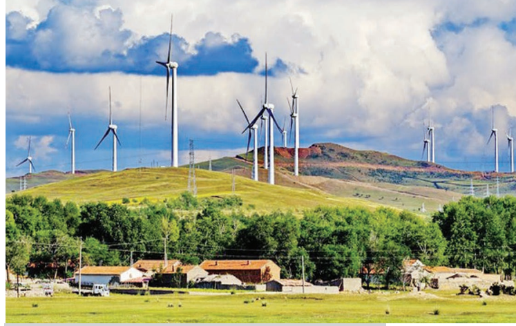
Kuzey Çin'in Hebei eyaletinde yer alan Zhangjiakou'da bir rüzgar enerjisi santrali. (Xinhua, 2021)
